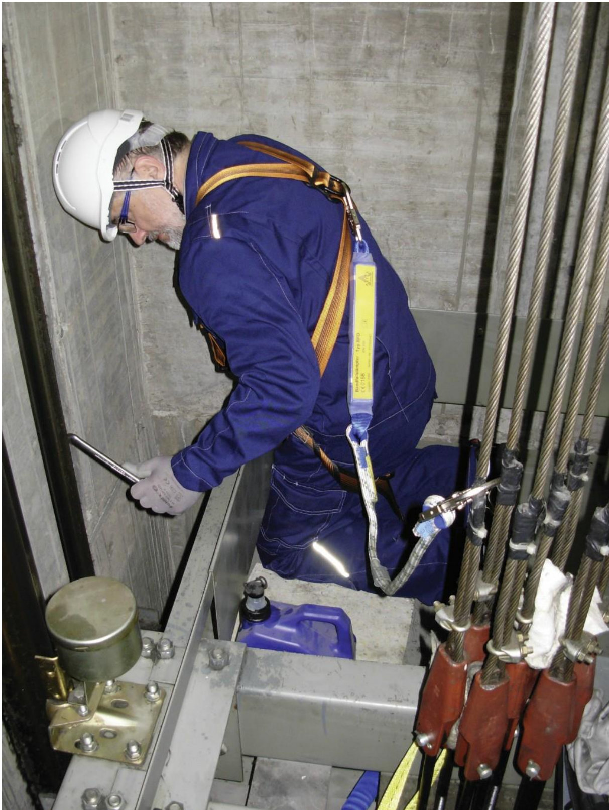
Bild 2 Ein temporärer Anschlagpunkt erfordert besondere Nachweise. Bilder: BGHM
