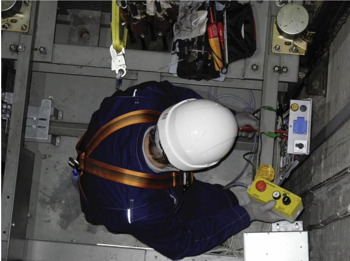
Bild 1 Das auf dem Fahrkorbdach vorhandene Geländer ist als alleinige Schutzmaßnahme gegen Absturz nicht ausreichend. Foto: BGHM
